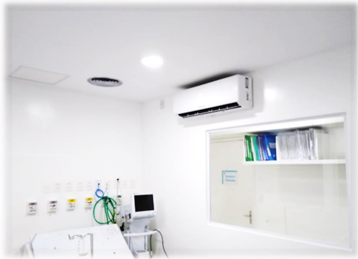
Figura1: Isolamento da UTI.
